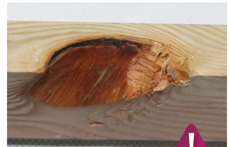
Kantenausbruchäste - vereinzelt einseitig zulässig
