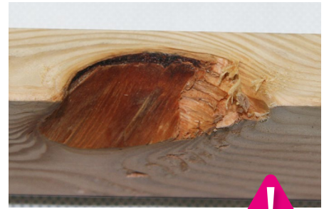
Kantenausbruchäste - vereinzelt einseitig zulässig
