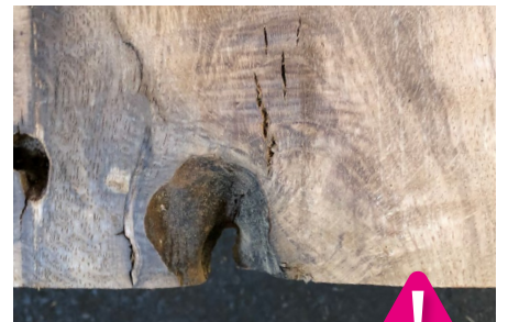
Kantenausbruch - bis 50 mm zulässig
